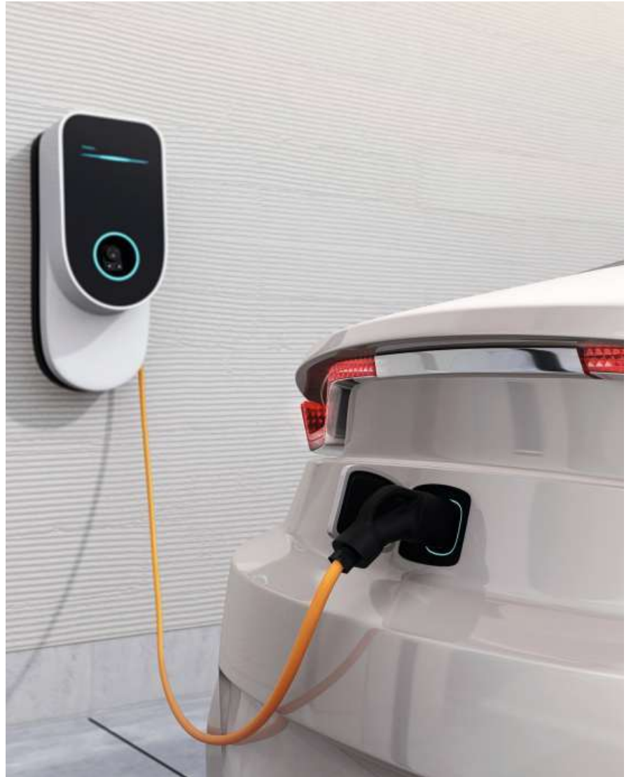
Grosse Unterschiede bei den Kosten für die Abrechnung des Ladestroms: Eigentümergemeinschaften sollten sich über den Modus der Aufteilung verständigen.
